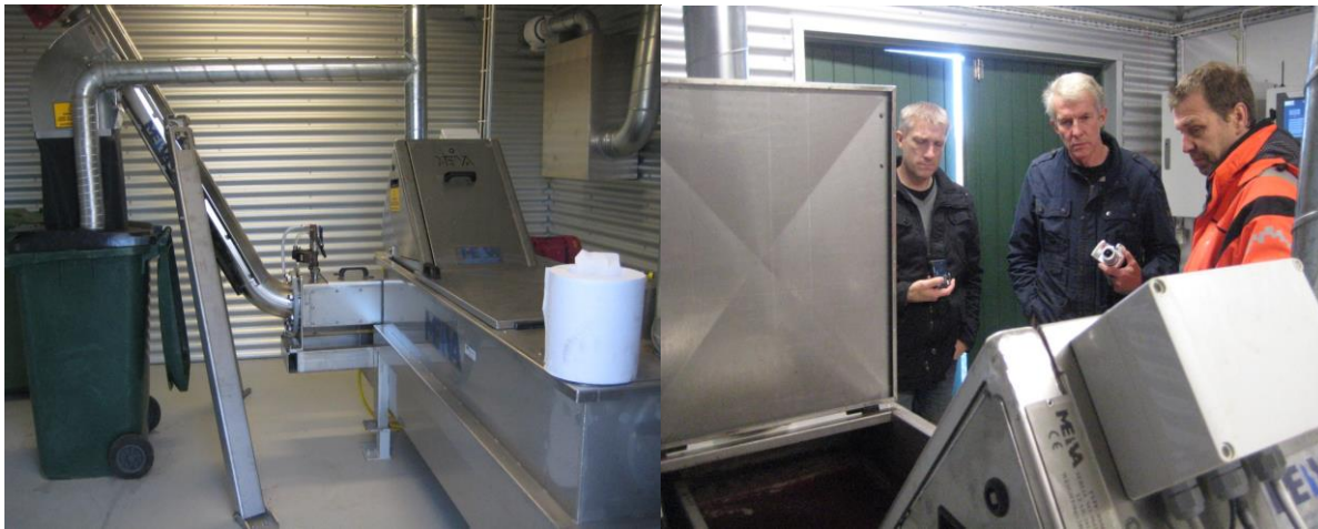
Mynd 10 Hreinsibúnaður fráveitunnar er snyrtilegur og fer ekki mikið fyrir honum, tölvan stjórnar innrennsli og losun, skráir rennsli og hitastig auk þess að hringja í umsjónarmann, ef eitthvað skildi bjáta á.
